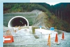
トンネル洗浄用水槽
