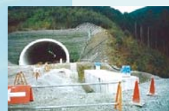
トンネル洗浄用水槽
